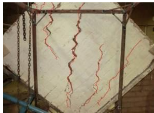
ت ۱۹. ترک های ایجاد شده در دیوار خشتی با ملات کاهگل پس از آزمایش کشش قطری.
