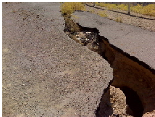
ت 5. شکستگی عمیق (به عمق 3 متر و عرض 0.5 تا 0.7 متر) در اثر حرکت دامنه در پایین دست جاده.
