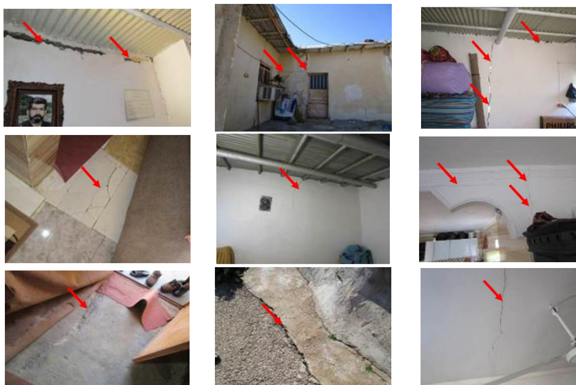
شکل ۵. نمایی از آثار رخداد زمین لغزش و خسارات وارد شده به منازل مسکونی روستای چزی علیا * محل ترک‌ها و شکاف‌های پر شده با نشانگر قرمز رنگ نمایش داده شده است.
