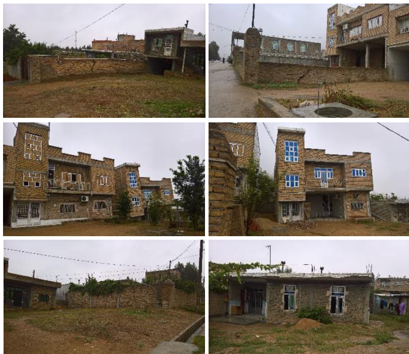
شکل ۲. الف: ترک خوردن دیوار بر اثر نشست زمین در شهر فراغی، ب: ترک خوردن دیوار بر اثر نشست زمین در شهر فراغی، پ: نشست ساختمان‌ها در شهر فراغی، ت: نمایی دیگر از وضعیت نشست ساختمان‌ها در شهر فراغی، ث: ترک خوردن دیوار بر اثر نشست در شهر فراغی، ج: ترک خوردن دیوار ساختمان بر اثر نشست در شهر فراغی
