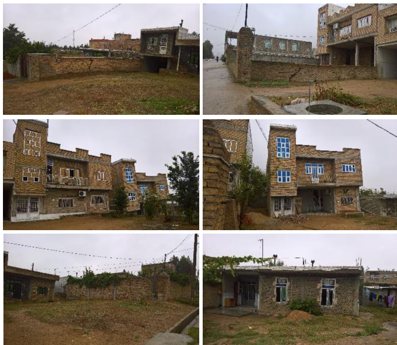
شکل ۲. الف: ترک خوردن دیوار بر اثر نشست زمین در شهر فراغی، ب: ترک خوردن دیوار بر اثر نشست زمین در شهر فراغی، پ: نشست ساختمان‌ها در شهر فراغی، ت: نمایی دیگر از وضعیت نشست ساختمان‌ها در شهر فراغی، ث: ترک خوردن دیوار بر اثر نشست در شهر فراغی، ج: ترک خوردن دیوار ساختمان بر اثر نشست در شهر فراغی
